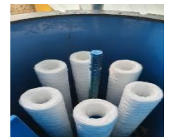
SWTS시스템 내부 필터 설치
